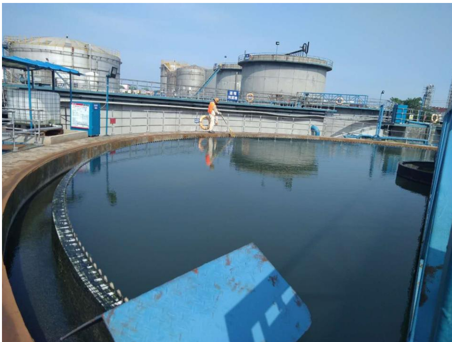
污水处理设施
